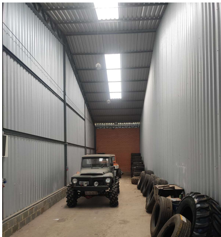
Figura 8. Iluminação interna do empreendimento.
