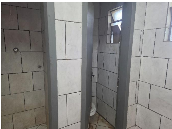
Figura 183 - Instalações do Aterro Sanitário
