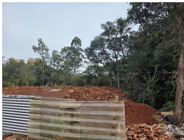
Figura 254 - Descarte inadequado de RCC
