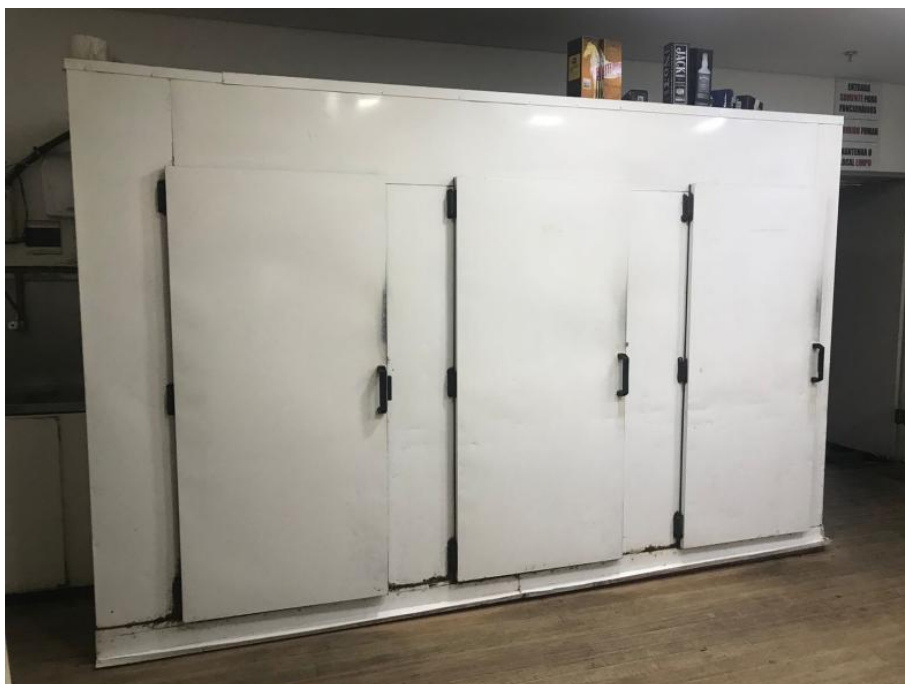
Imagem 17: refrigerador da copa
