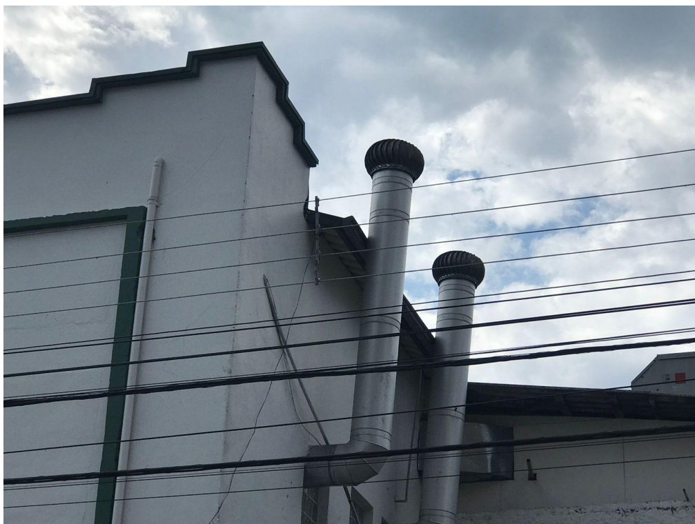
Imagem 32: saída das coifas para fora do telhado Fonte: arquivo próprio / janeiro de 2022
