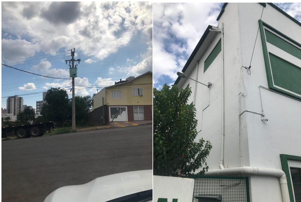
Imagens 79 e 80: medidor de energia elétrica na fachada do estabelecimento
