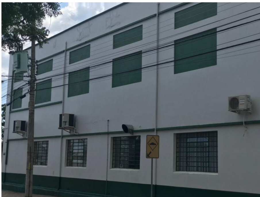
Imagem 65: restaurante - máquinas dos aparelhos de ar condicionado distribuídas ao longo das fachadas
