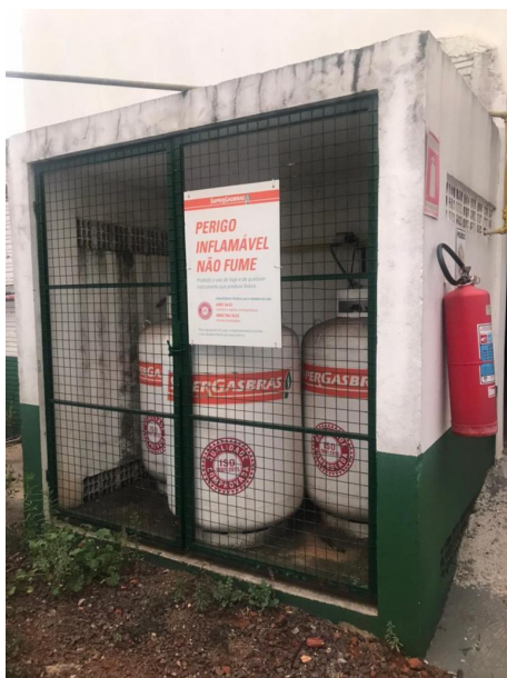
Imagem 47: armazenamento de gás fora da edificação
