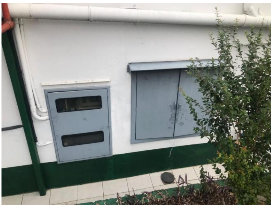
Imagem 81: entrada de energia elétrica no estabelecimento / quadro de energia
