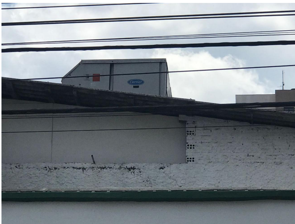
Imagem 66 : salão de baile - máquina do ar condicionado central do salão de baile no telhado
