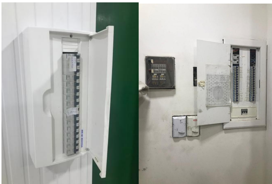
Imagens 82 e 83:quadro energia restaurante / quadro de energia salão de festas
