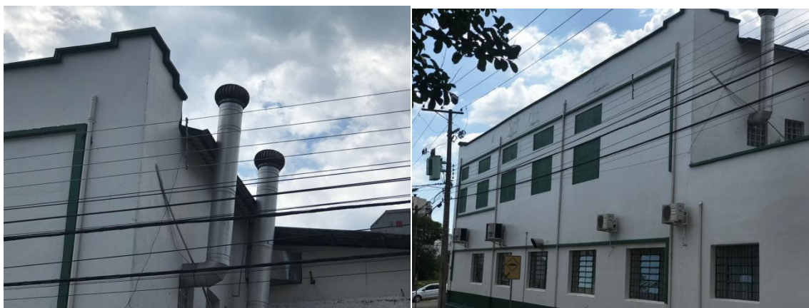
Imagens 84 e 85: saída das coifas pelas paredes
