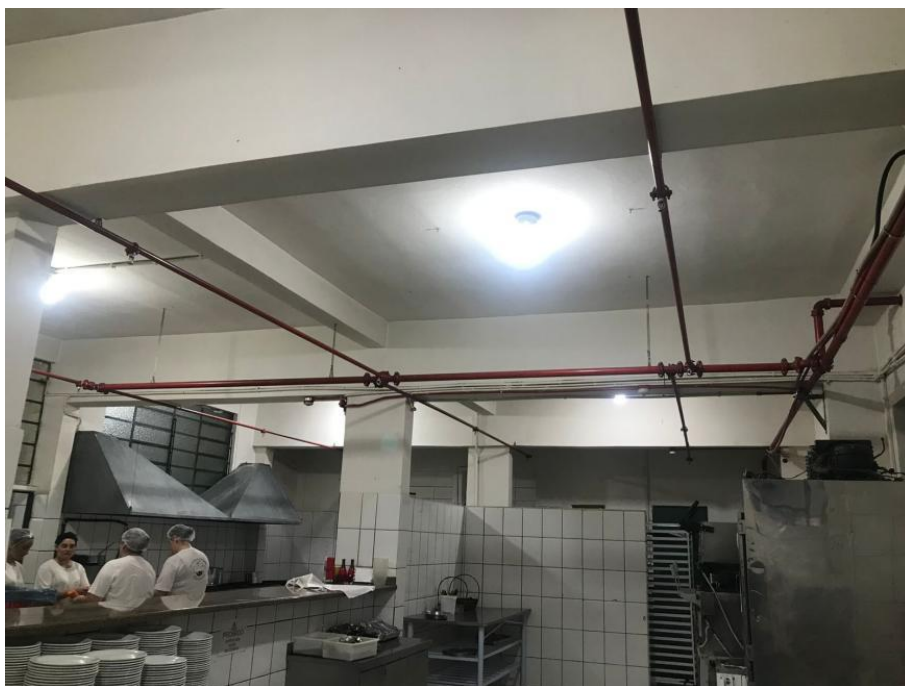
Imagem 58: cozinha do restaurante - distribuição de sprinklers
