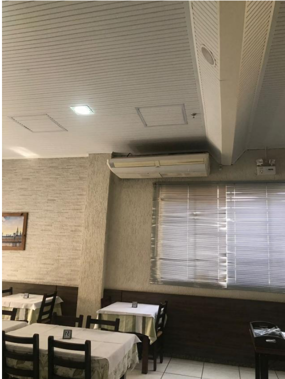
Imagem 62 : Restaurante - aparelhos de ar condicionado distribuídos ao longo do salão
