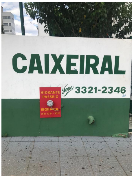
Imagem 48 : hidrante de passeio - muro na Rua Severiano de Almeida
