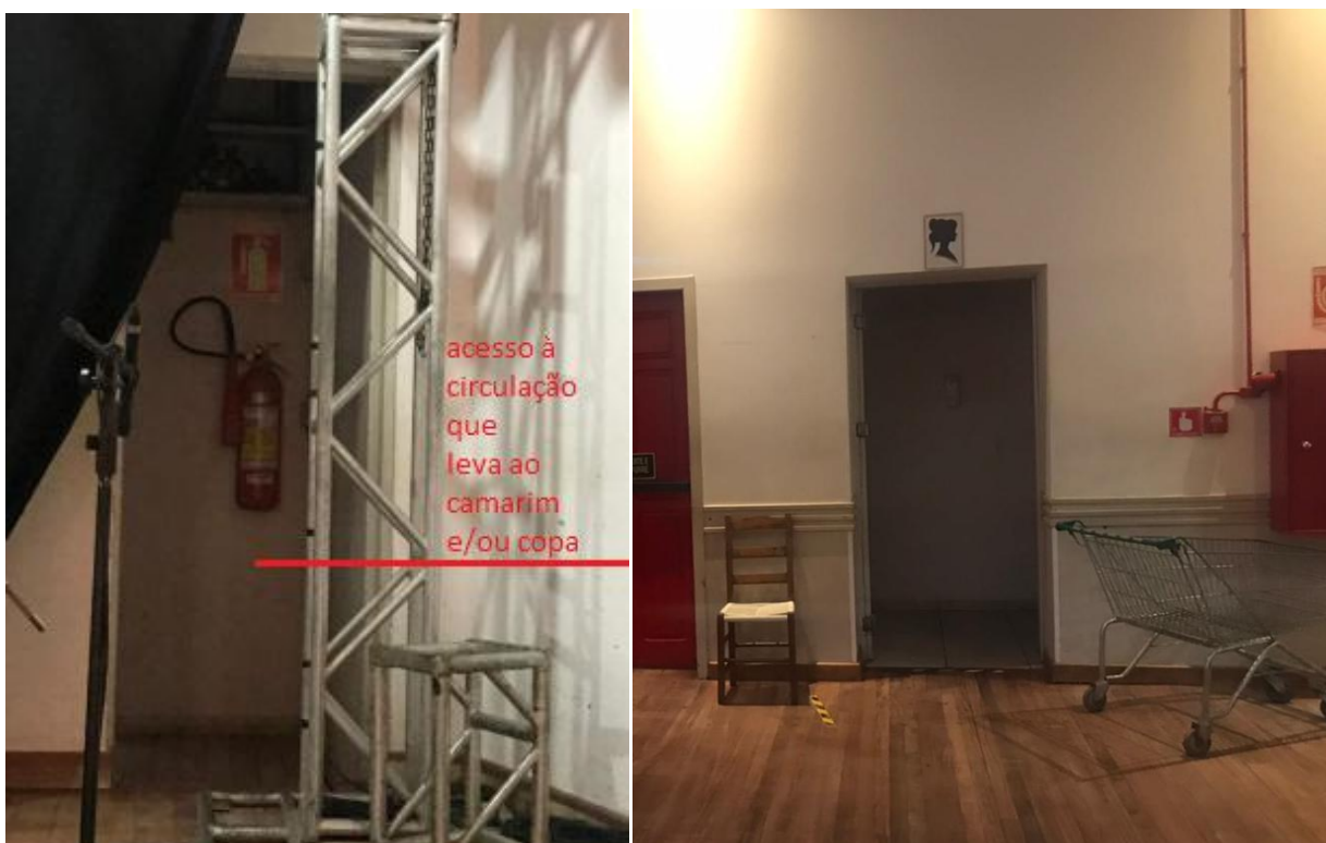
Imagens 51 e 52: salão de baile - extintor de incêndio próximo ao palco / hidrante ao lado do banheiro feminino
