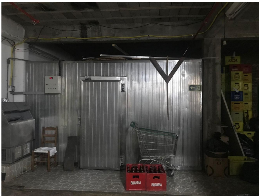
Imagem 15: câmara fria com gerador Fonte: arquivo próprio / janeiro de 2022
