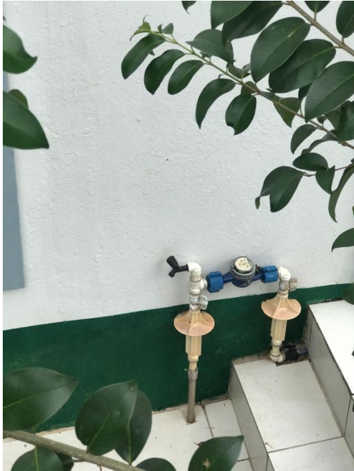
Imagem 70 : registro de água na lateral da edificação
