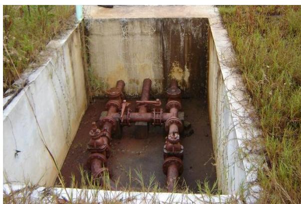
Figura 62: Elevatória da lagoa de decantação de lodo.
