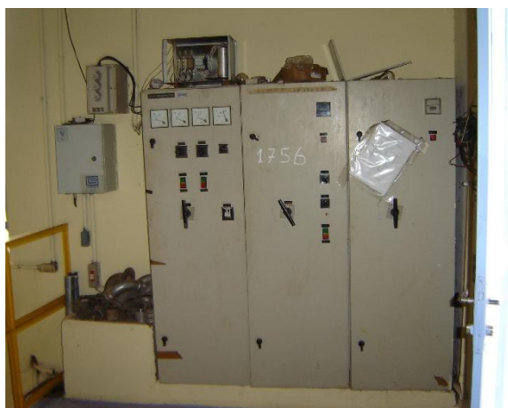
Figura 83: Quadro de comando dos motores partida direta.
