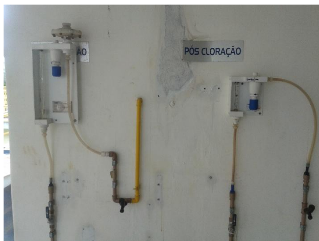
Figura 54: Dispositivo de aplicação do cloro gás.
