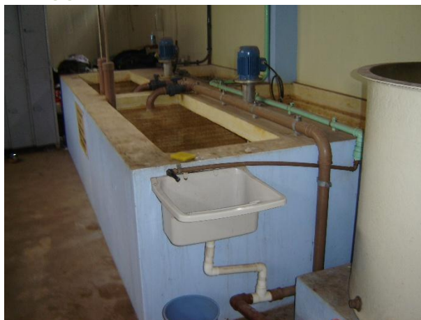
Figura 67: Reservatório de Sulfato de Alumínio Líquido.
