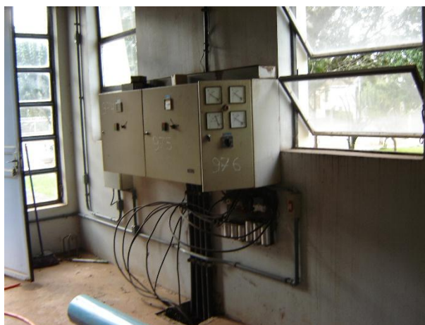
Figura 85: Quadro de comando dos motores partida direta.
