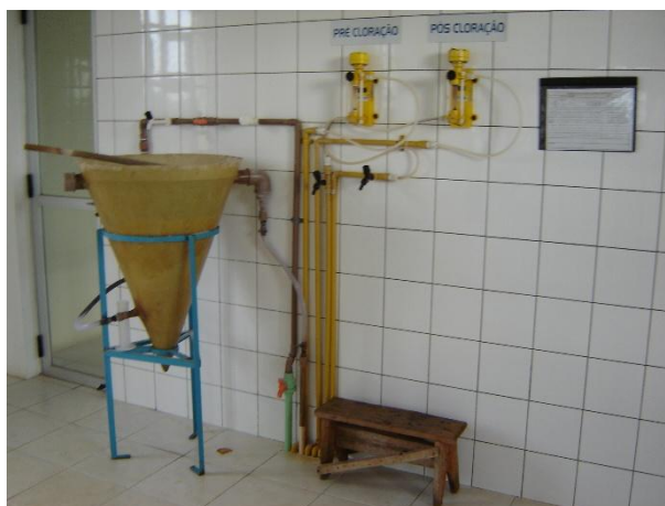
Figura 68: Dosador de Flúor e cloro gás.
