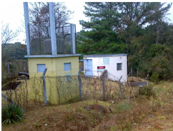
Figura 71: Elevatória de água bruta do Rio Campo.
